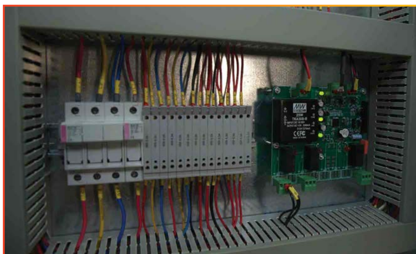
نمایی از بردها و تجهیزات داخلی یک شارژر خطی
